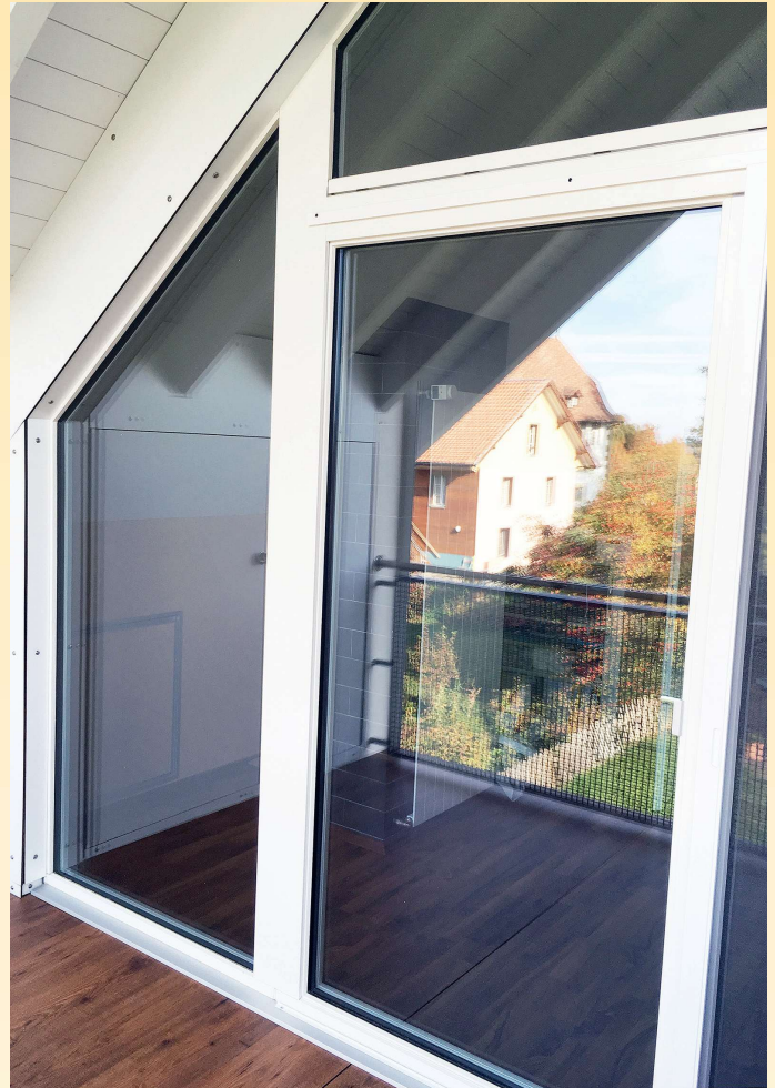
Fenster in Dachschräge
